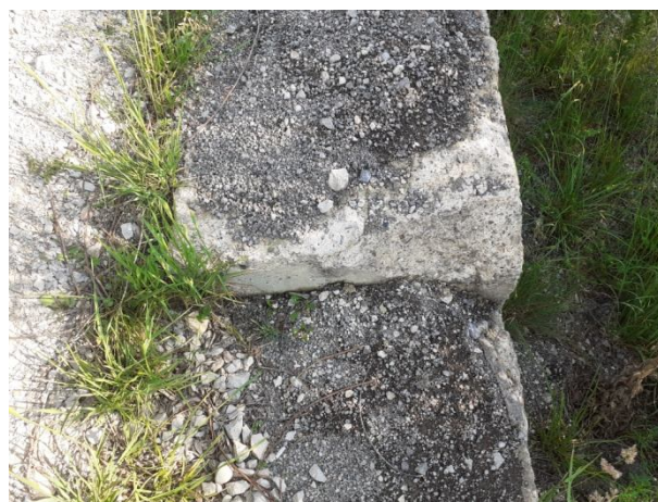
Повърхностна ерозия на бетона
