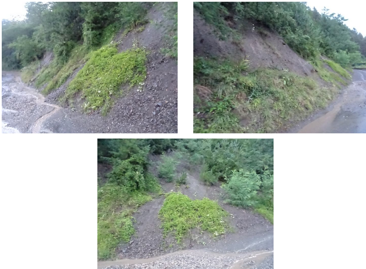
Изглед към свлачищния участък
