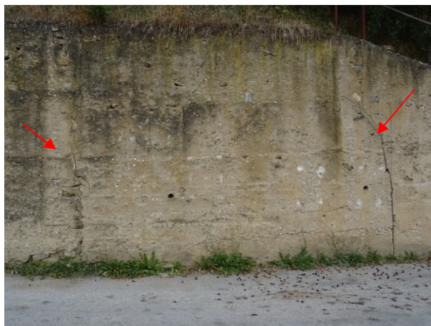
Деформации по съществуваща стара подпорна стена над главната улица
