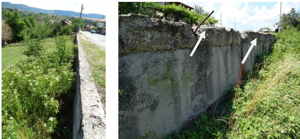
Силово укрепително съоръжение и нарушения в бетона при короната на стената
