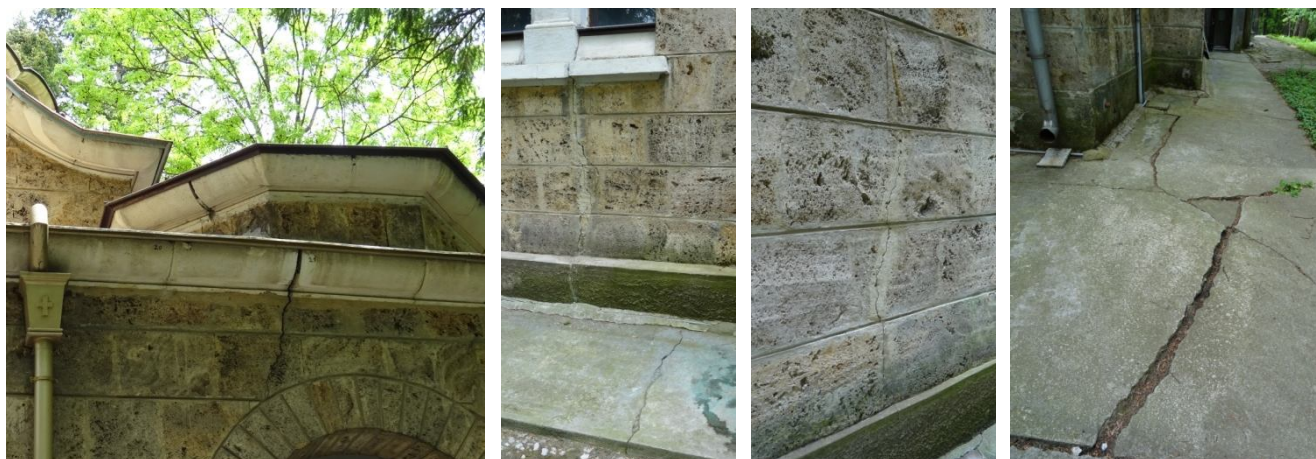
Пукнатини по фасадата на църква „Св. Св. Кирик и Юлита”
