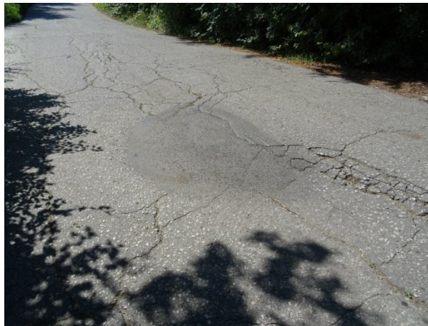
Силно нарушено асфалтово покритие
