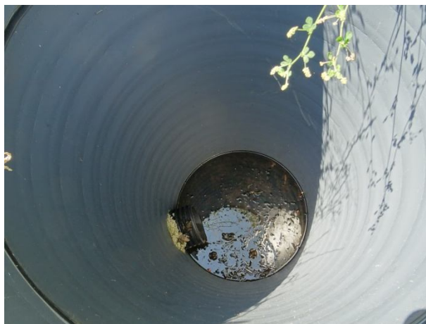
Състояние на отводнителните съоръжения
