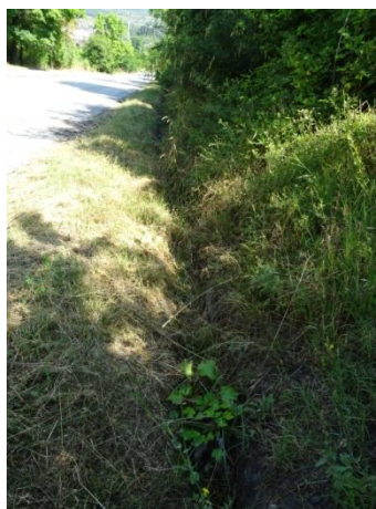
Затлачена повърхностна канавка
