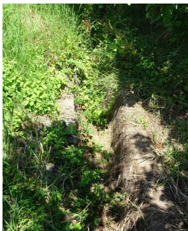
Състояние на канавката над пътя
