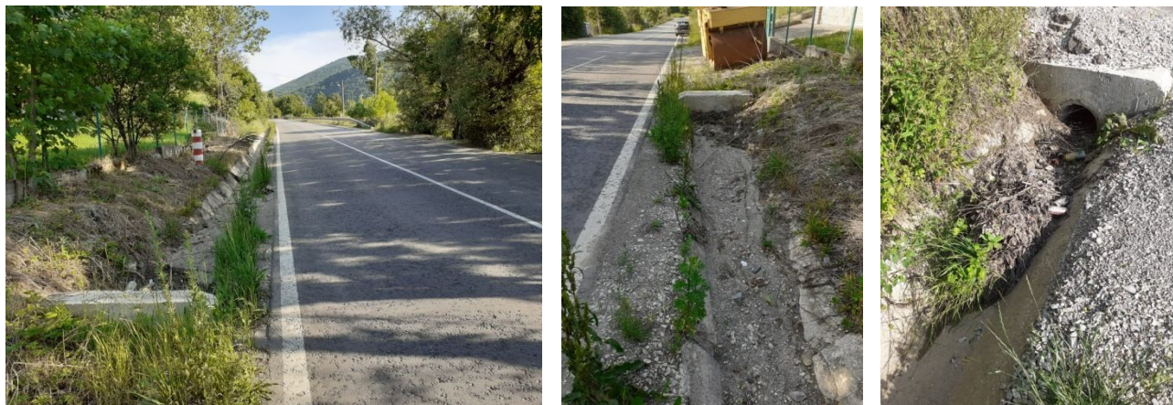
Състояние на бетоновия окоп общ поглед и натрупан наносен материал при втоците
