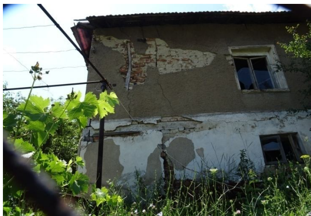
Деформации по сграда на ул. „Еделвайс” № 24
