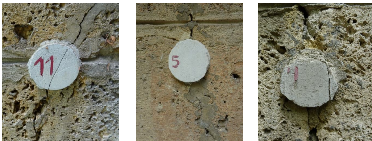
Репери и гипсови марки по фасадата
