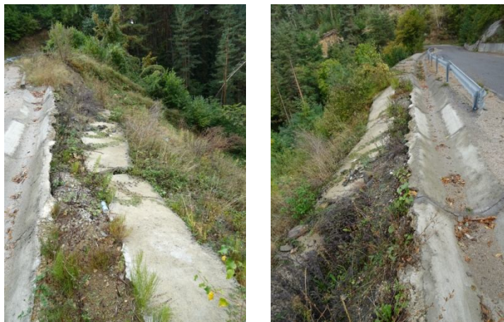
Разрушена част от облицования пътен окоп
