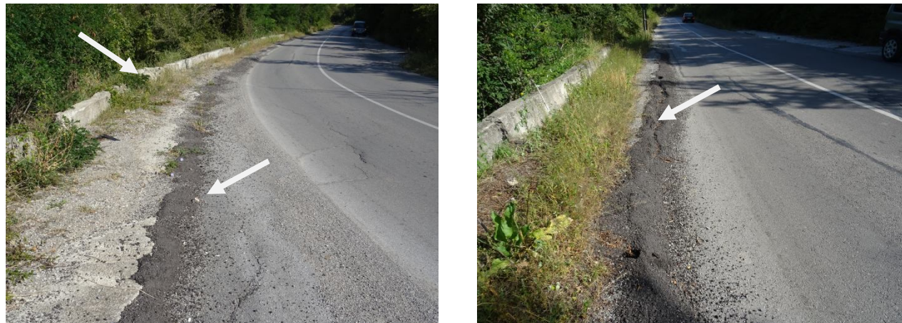
Място на разрушената част от стената и състояние на пътното платно в този участък
