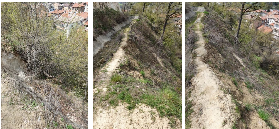
Ерозия по терена на ската
