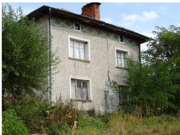
Сграда с деформации в имот пл.сн. № 47
