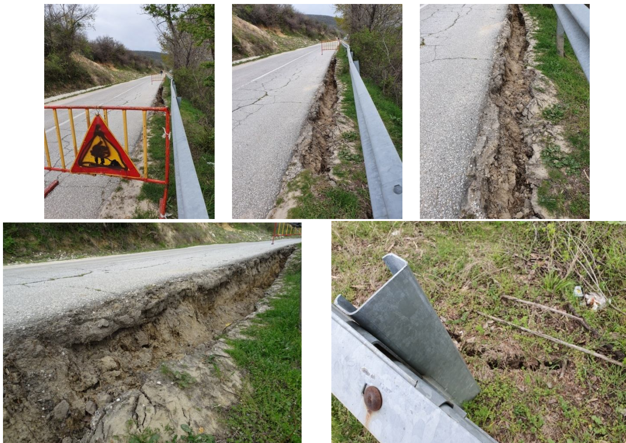
Отстъп и деформация на пътното платно при km 40 +910
