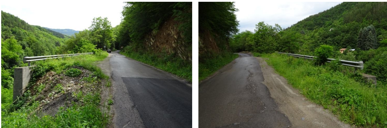
Укрепен свлачищен участък на път SFO 3611 при km 4 +300
