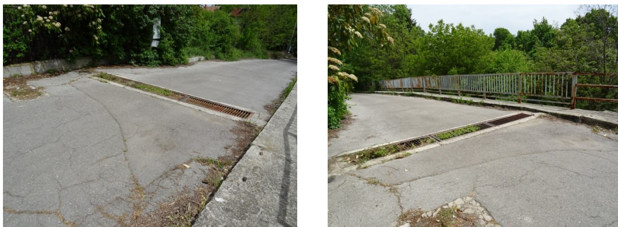
Дъждоприемен отводнителен канал
