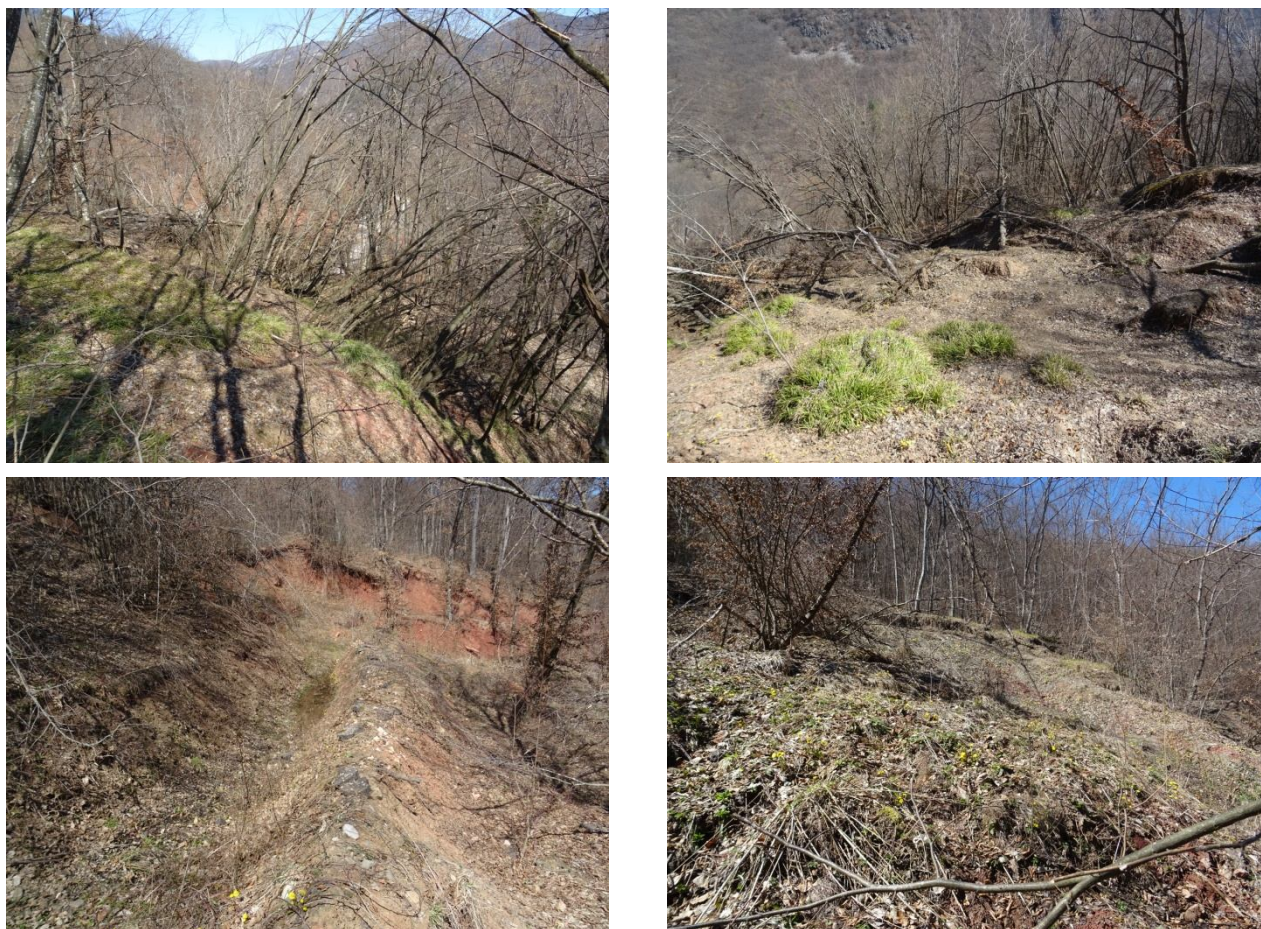
Изглед от свлачищното тяло в близост до главния свлачищен откос
