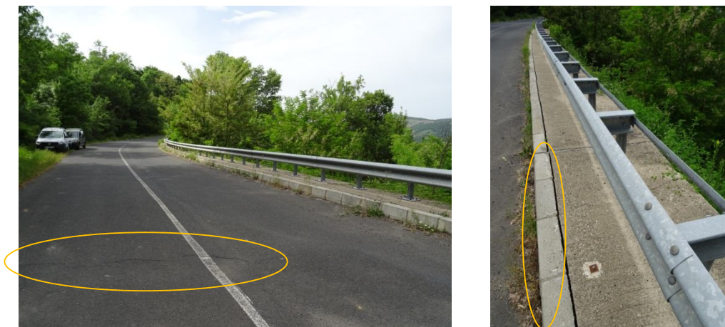
Деформации в обсега на укрепения участък
