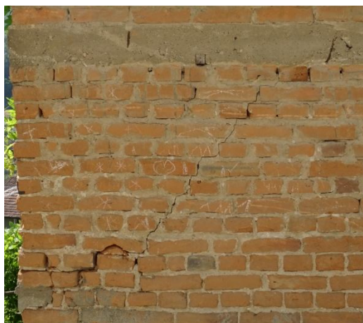
Пукнатини по фасади
