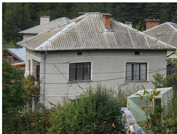
Сграда с деформации в имот пл.сн. № 49
