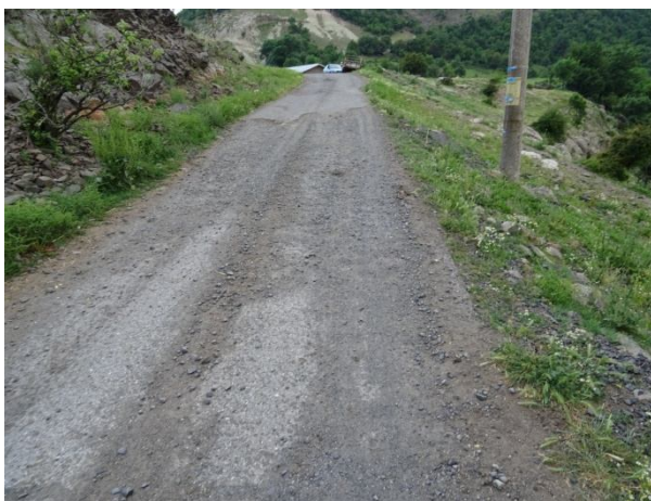
Състояние на път KRZ 1370
