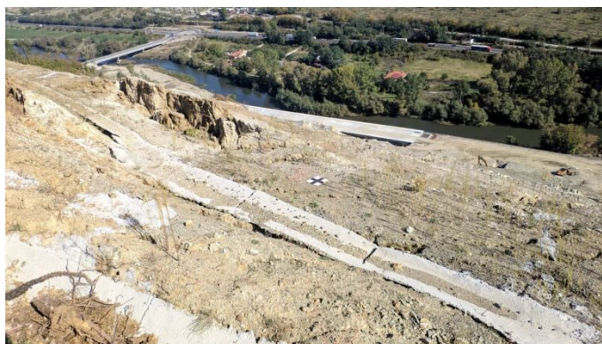
Разрушена повърхностна отводнителна канавка
