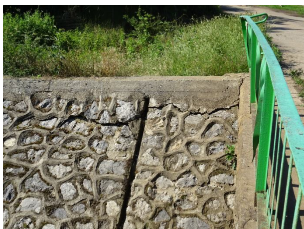
Пукнатина по каменна облицовка по левия бряг
