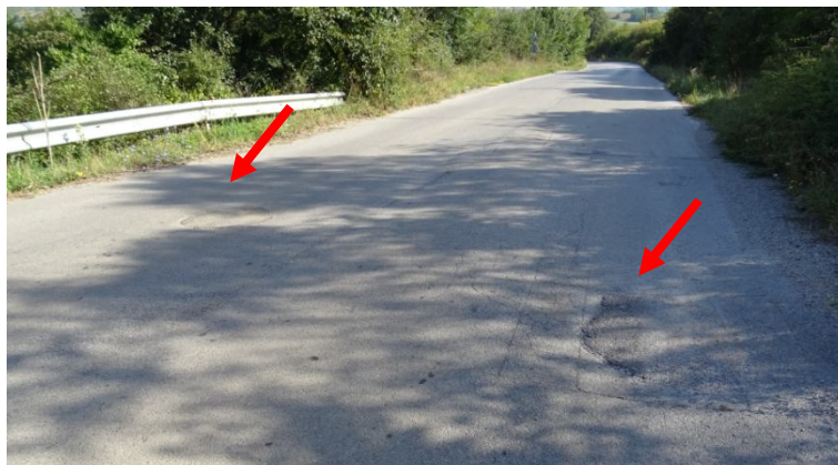
Състояние на асфалтовото покритие над водостока и двете кръгли кръпки
