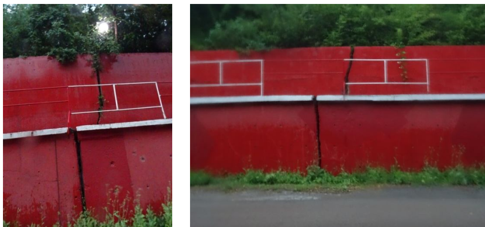
Деформации по подпорната стена на път III-164
