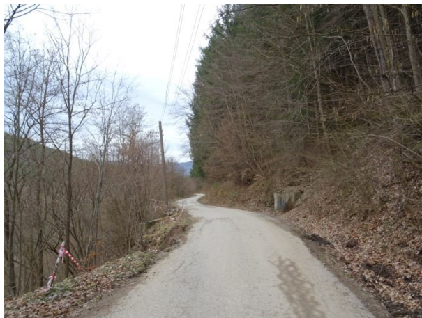
Общ изглед към засегнатия пътен участък km 2 +700 при чешмата /10.03.2023 г./
