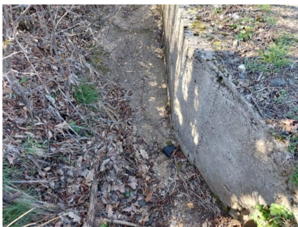
Заустване на водите от дренажа в крайпътната канавка /март, 2023 г./
