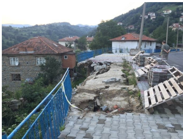
Разрушена подпорна стена и парапет /2018г./
