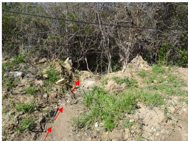
Изтичане на битови води в главния откос
