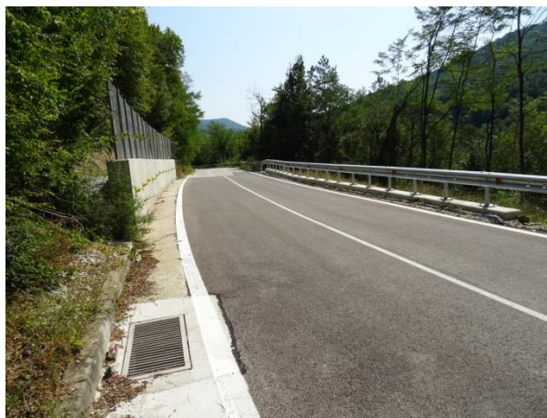
Водосъбирателна шахта с вток
