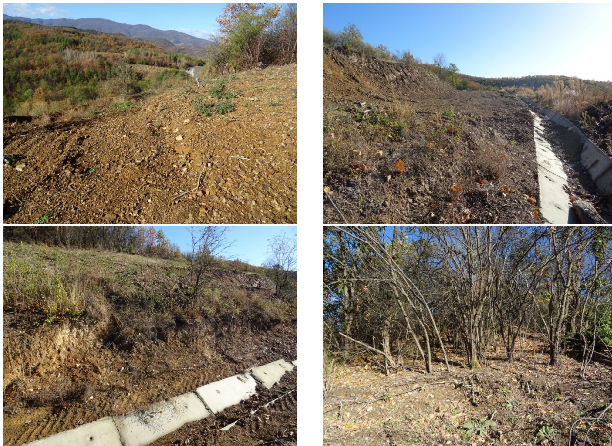
Неясно изразени деформации при десния свлачищен борд
