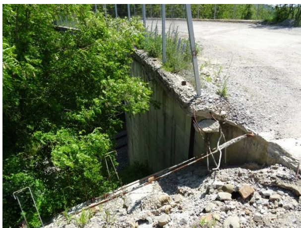
Конструктивни нарушения по мостовото Съоръжение
