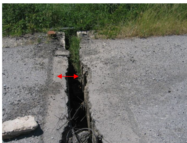
Деформации по дилатационна фуга на ростверка
