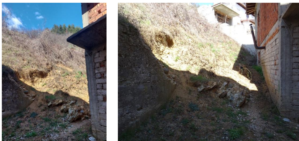
Свлечени земни маси опрени в западната фасада на жилищната сграда
