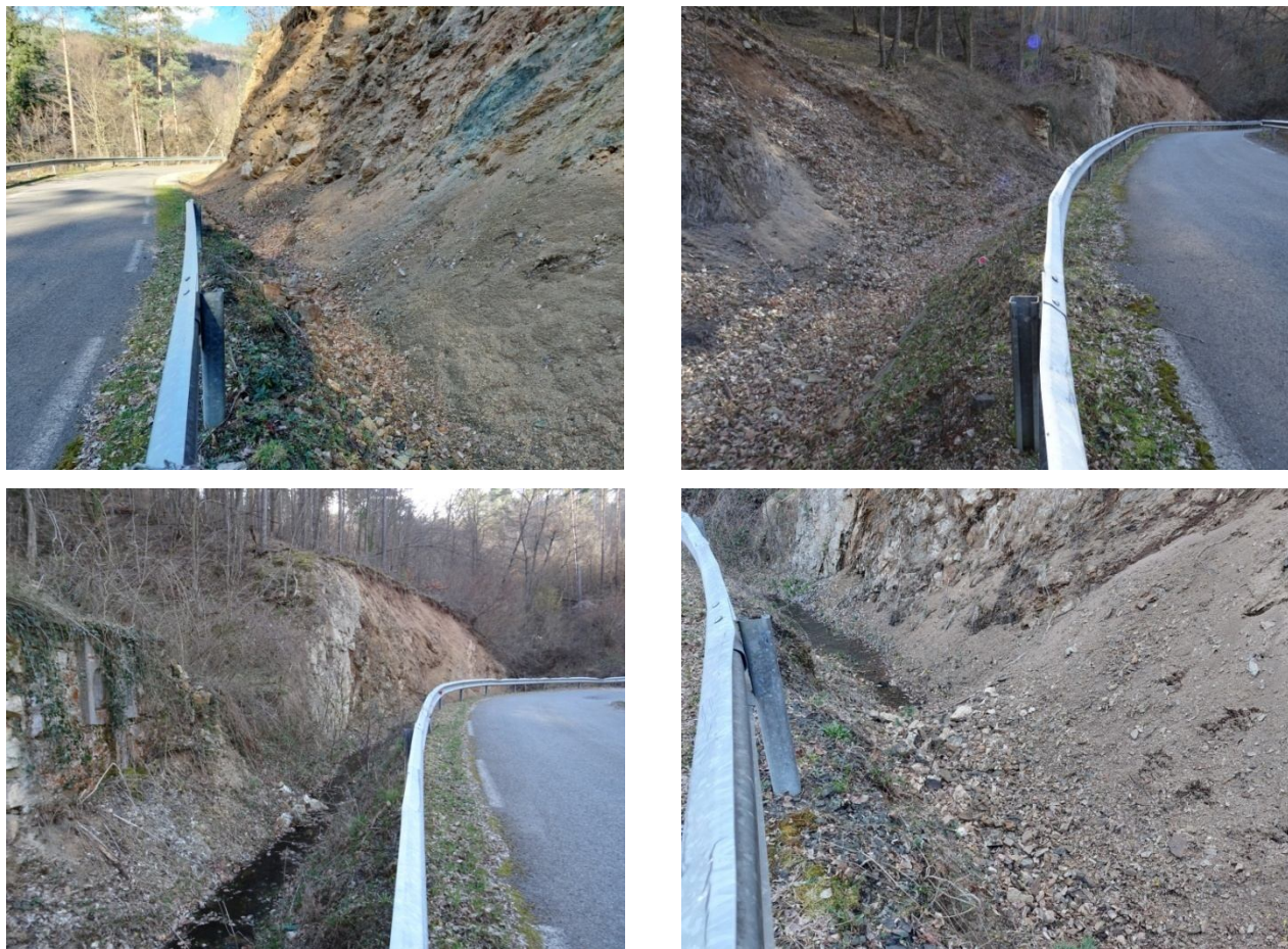
Състояние на канавката
