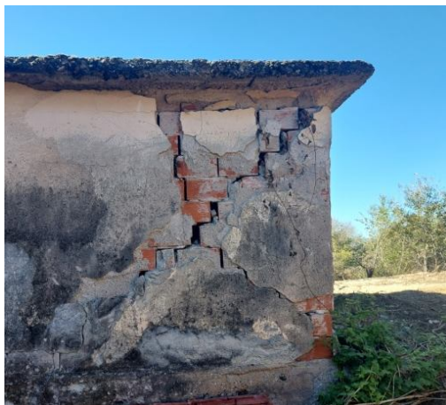
Силно деформирана пристройка
