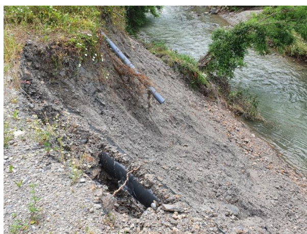
Състояние на веждата на обрушения откос след свличането
