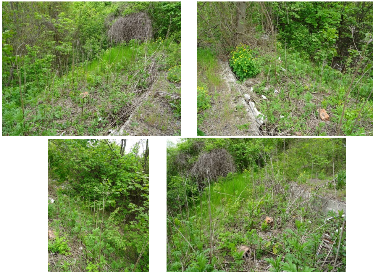
Състояние на свлачищния откос /май, 2023 г./
