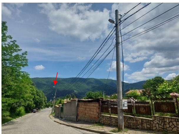
Наклонен ел. стълб на ул. „Искър”
