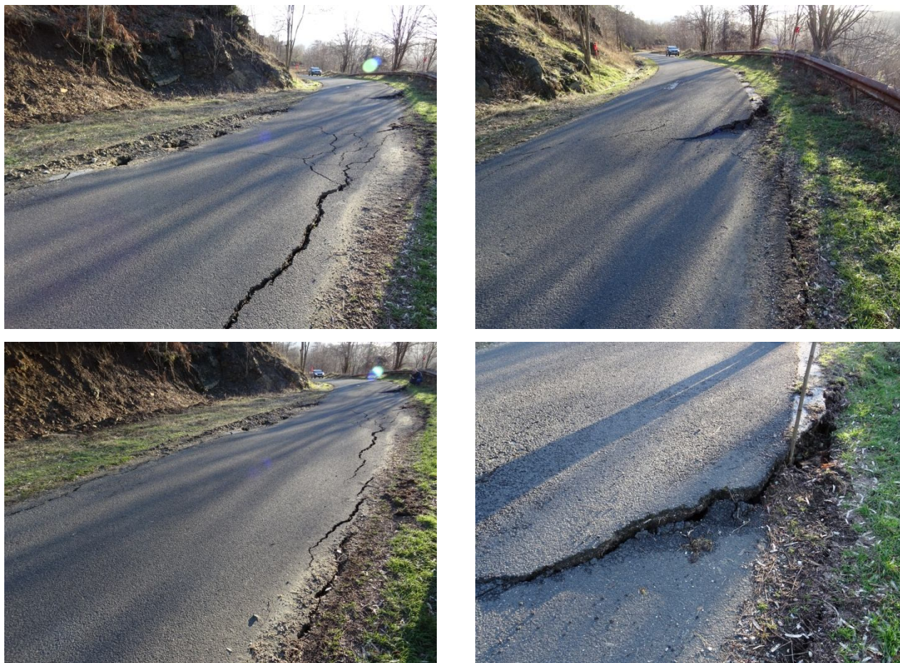
Свлачищни деформации по асфалтовата настилка, 2021 г.
