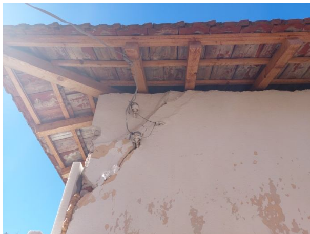
Силно деформиран североизточен горен ъгъл на сградата
