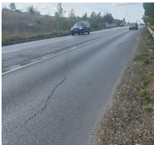
Пукнатина на срязване по път I-1
