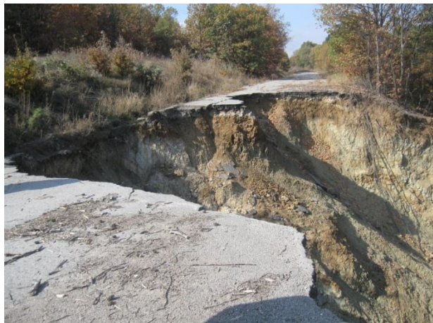
Напълно разрушено пътно платно /2015 г./
