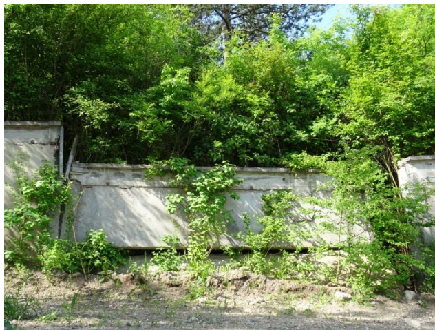
Неремонтирани бетонови ламели
