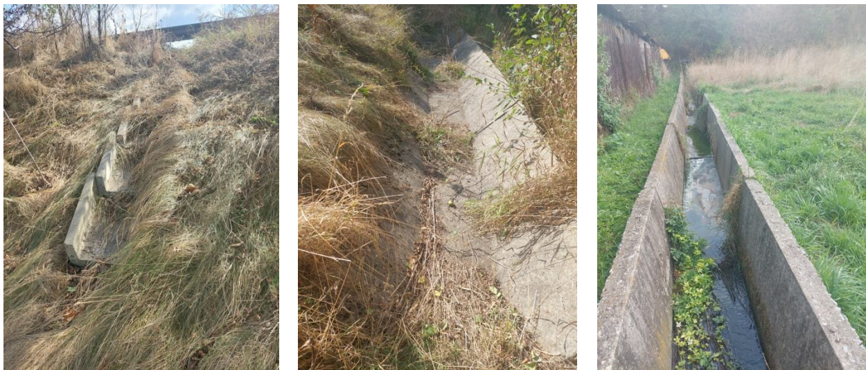
Отводнителни съоръжения по въздушния откос на републикански път I-1
