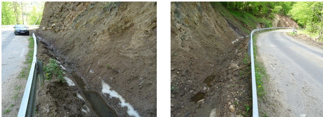
Отводнителна канавка на пътя /май, 2020 г./
