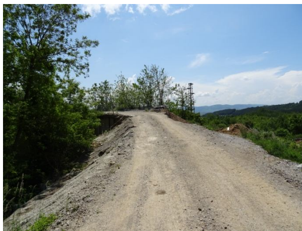
Силно стеснен обслужващ път без сигнализация
