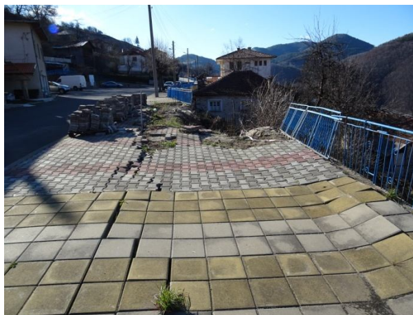
Денивелирана пукнатина на срязване /март, 2023 г./
