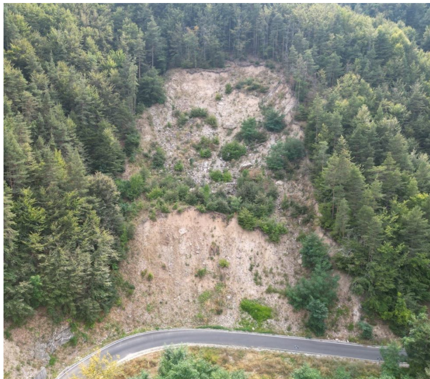
Панорамен изглед на свлачищния участък
