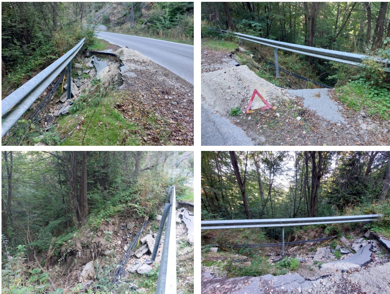
Общ изглед на свлачищния участък
