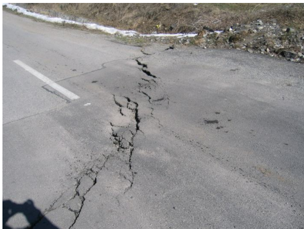
Денивелирана пукнатина на срязване, 2010
