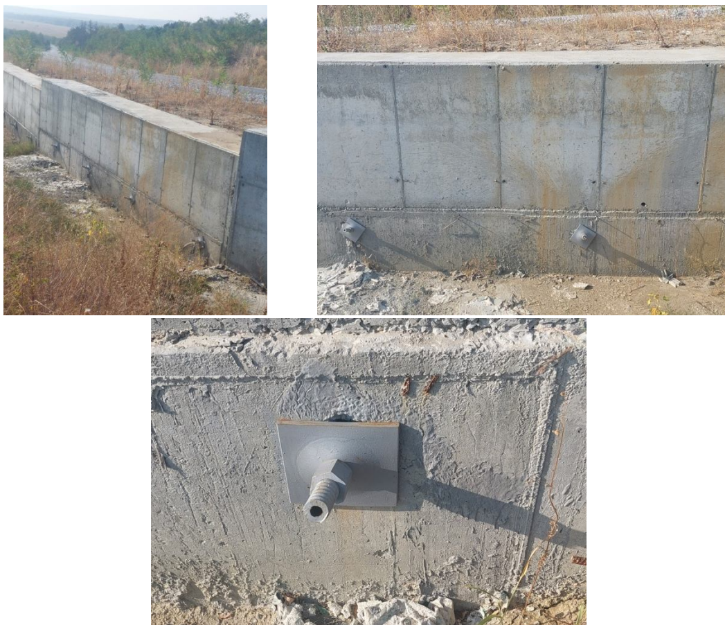
Анкериране на силовото линейно съоръжение
