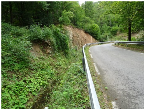
Състояние на канавката /август, 2021 г./
