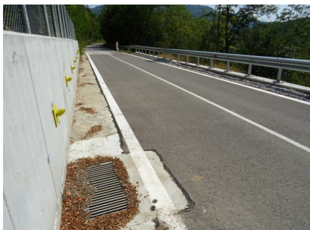
Водосъбирателна шахта с вток
