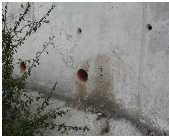
Барбакани \varnothing 100 mm в основата на подпорната стена
