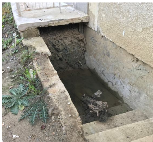
Кални отложения при подхода към сутеренните помещения на сградата /октомври, 2020 г./
