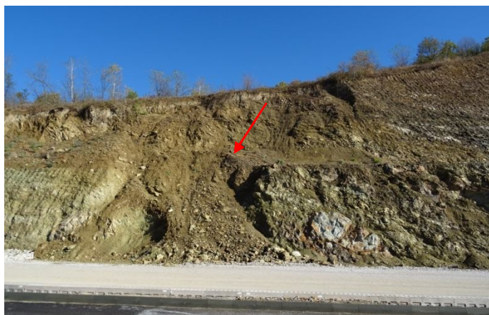
Консистентно свличане в северозападната зона на свлачищния масив
