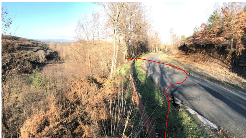
Общ изглед на свлачищния участък, 2021 г.
