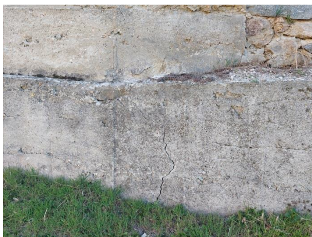
Каменно-зидана стена и вертикална пукнатина в бетоновата част от стената /март, 2023 г./
