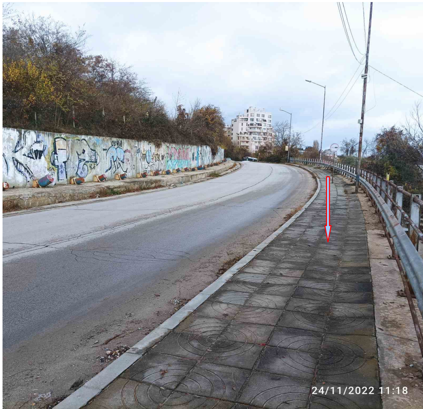
Сн. 2 ПАК и пукнатини по източното пътно платно – изглед - североизток
