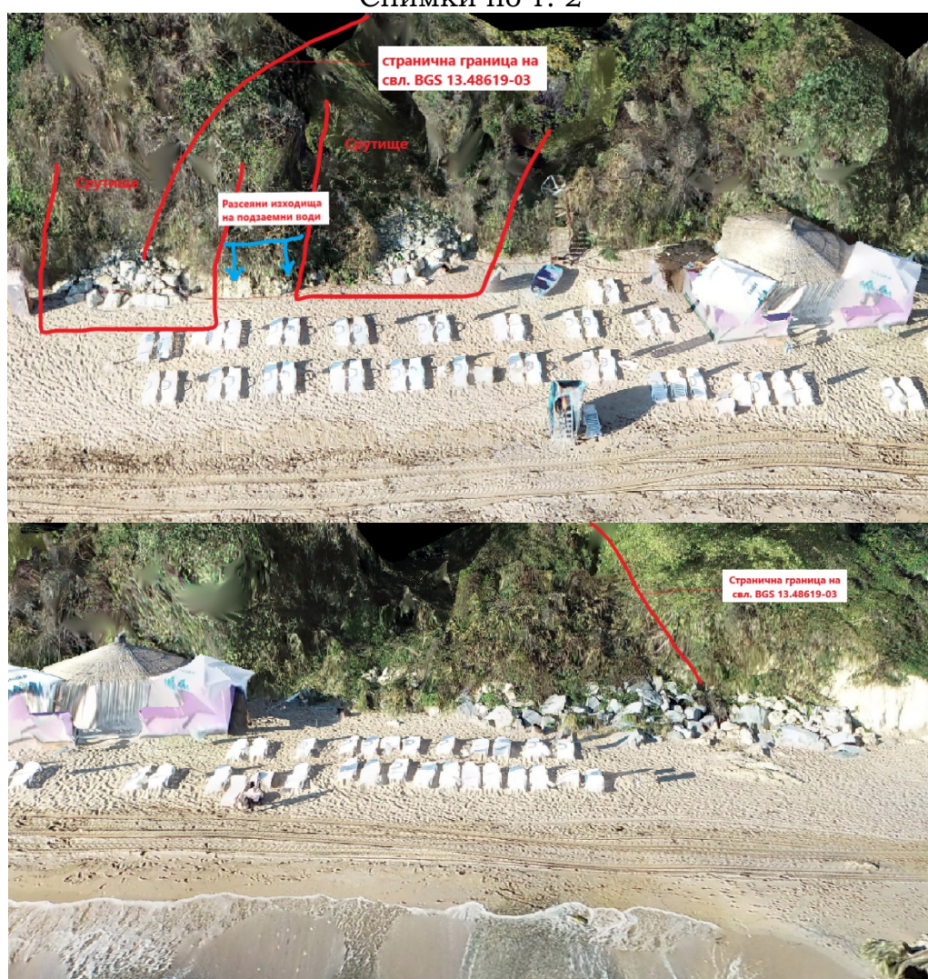
Снимки по т.3 – обрушвания при източната граница на свлачището
