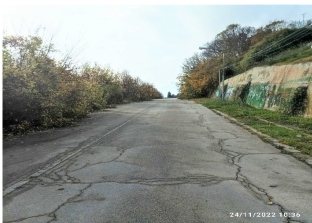
Сн.5 Участъкът, от път VAR 1082, над свлачищния отстъп
