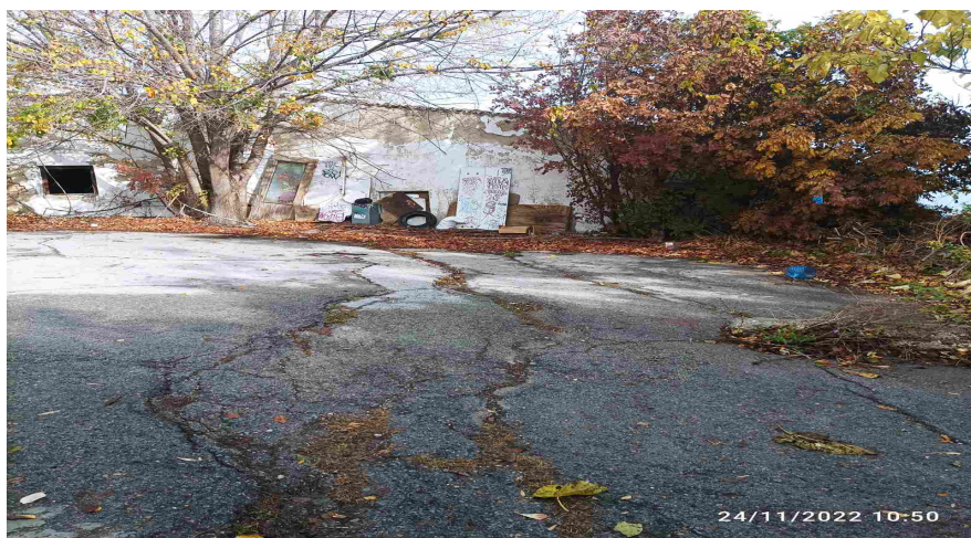
Сн. 4 Пукнатини в югоизточната част на ПИ 10135.2573.211- р-т „Трифон Зарезан“
