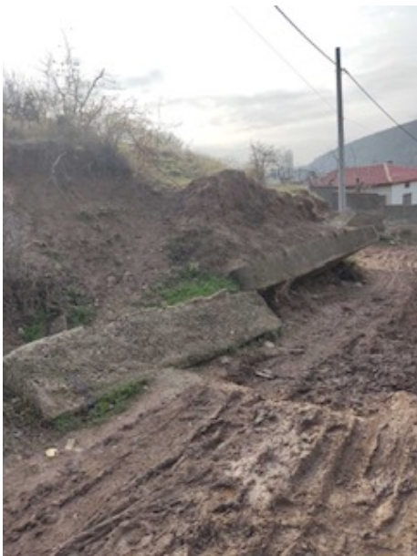
сн.3: разрушена подпорна стена
