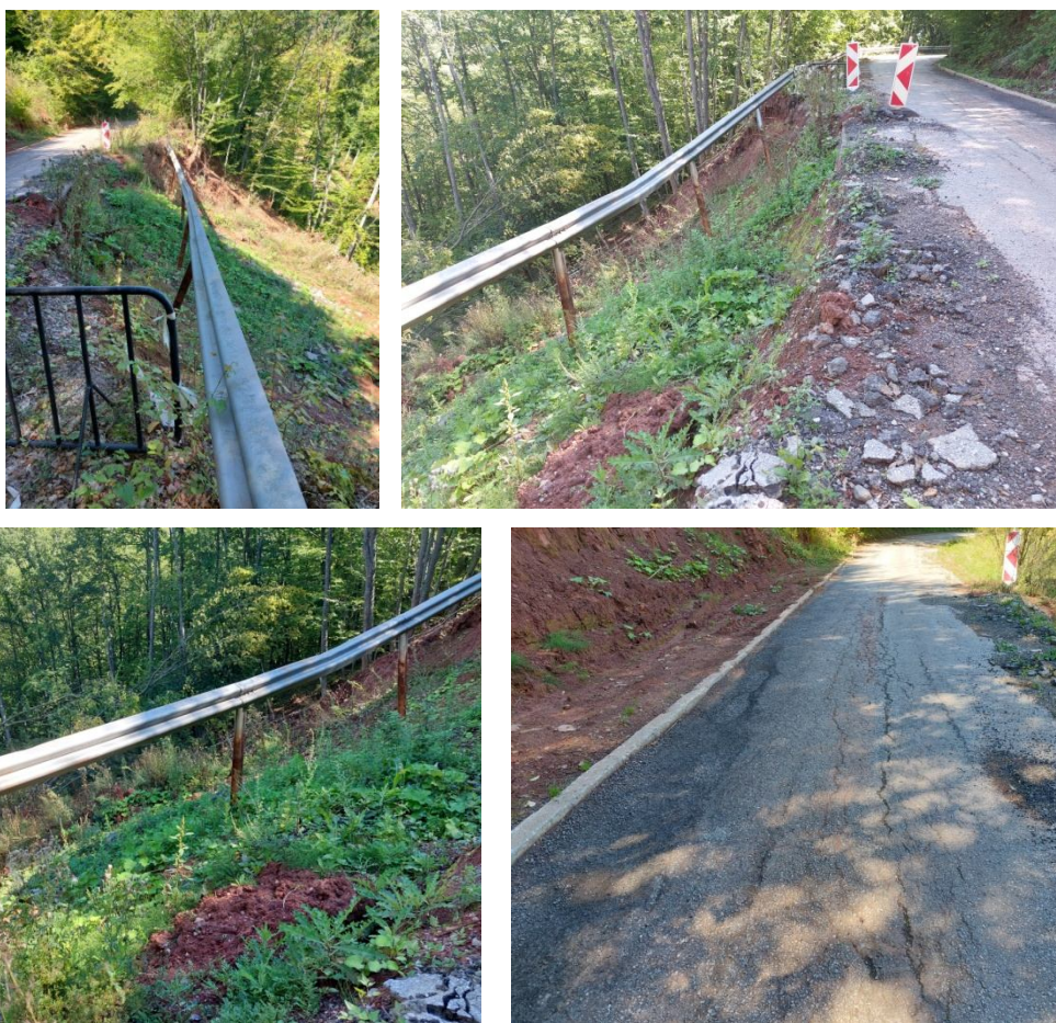
Главен свлачищен откос и нарушено пътнo платно
