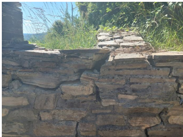
Деформирани стълбища и стени към северозападната сграда в УПИ I-571
