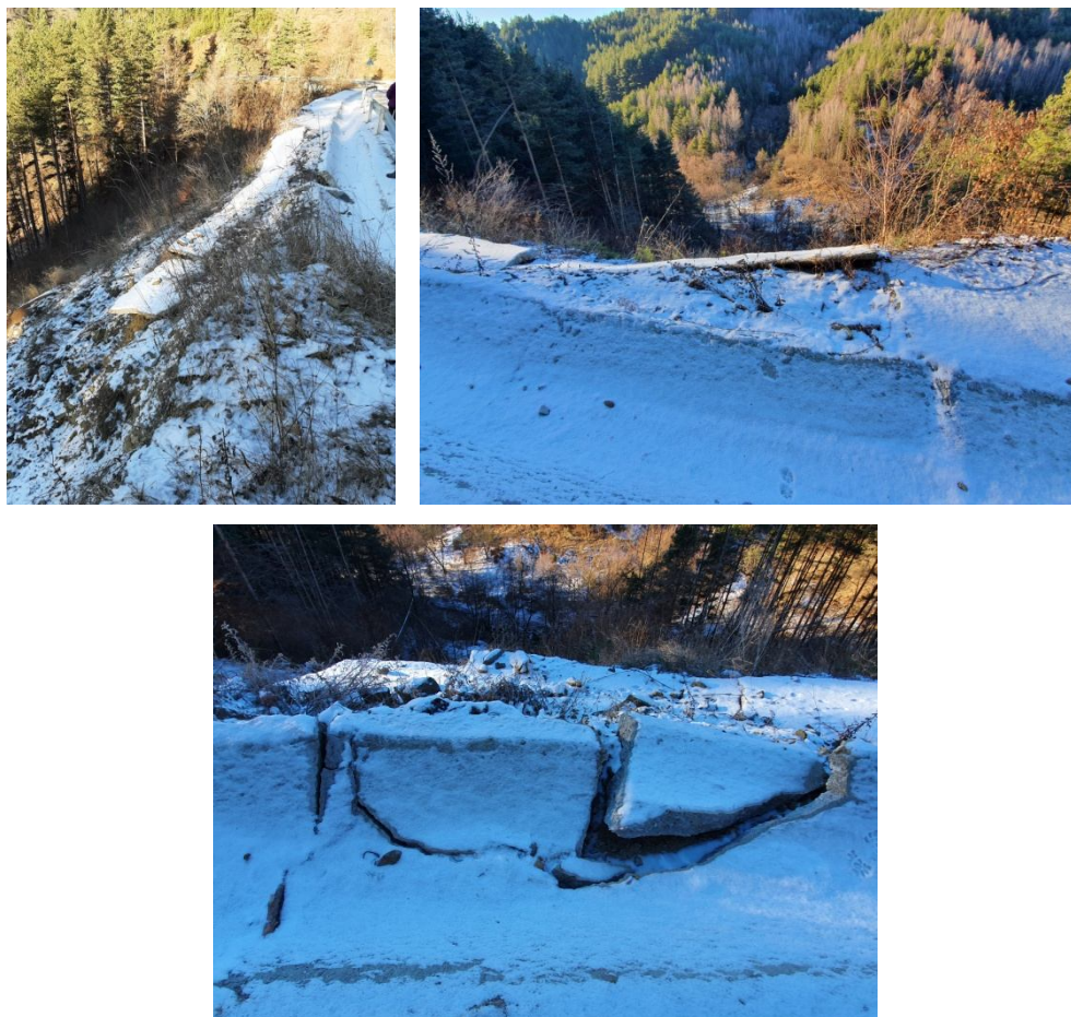
Разрушена част от облицования пътен окоп, 2021 г.
