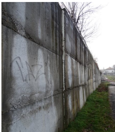
Деформация на шеста ламела, 2021 г.
