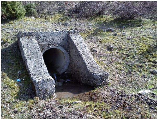
Водосток на път III-865 /март, 2015 г./
