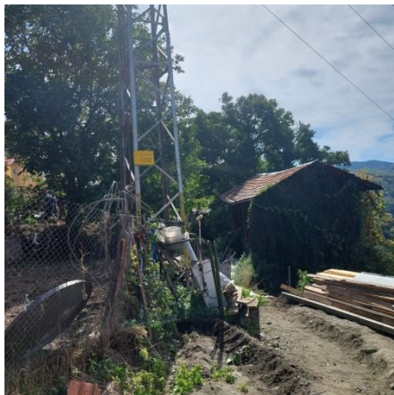
Електрически стълб над главния свлачищен откос
