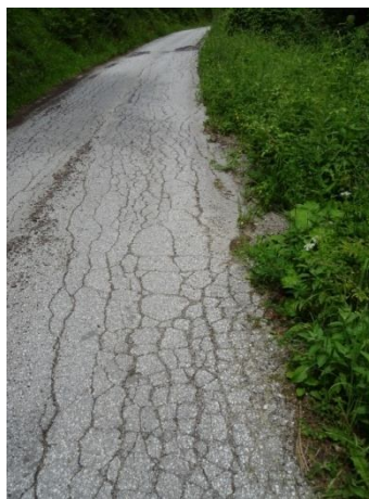
Мрежовидни пукнатини по настилката на пътя
