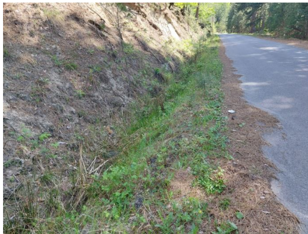
Земна отводнителна канавка
