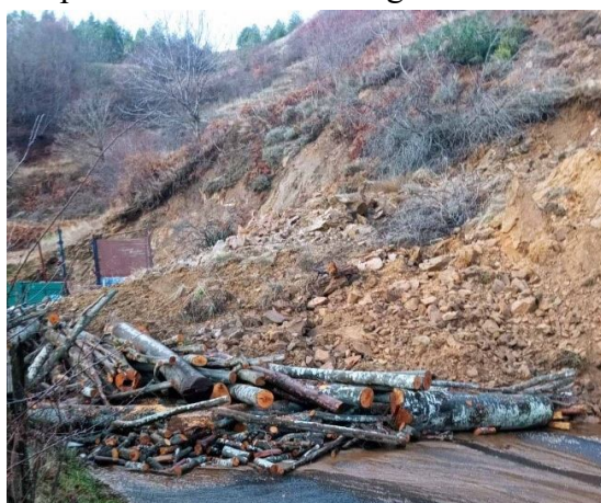
Изглед към свлачищно-срутищния участък при възникването на процеса /декември, 2021 г./
