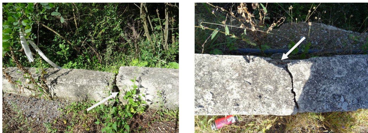
Скъсана надлъжна монтажна армировка при вертикалните пукнатини /2020 г./
