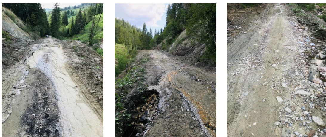
Състояние на път SML 2240 в района на свлачищния участък
