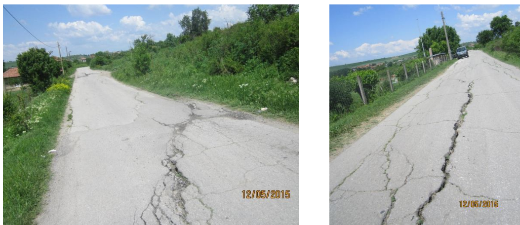
Участъци с пропадане на пътното платно и възникнали пукнатини на срязване
