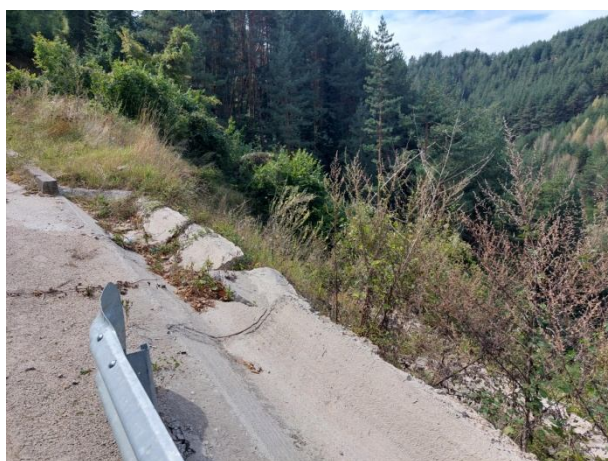
Частично разрушен облицован пътен окоп
