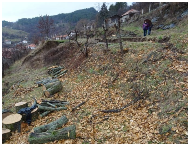
Пукнатини на срязване, 2021 г.
