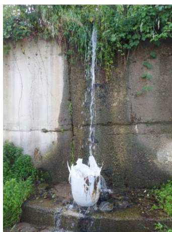
Компрометирана шахта и нерегулирано изливане на вода върху фундамента на стената
