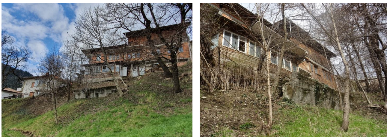
Наклонена и деформирана стара подпорна стена /април, 2021 г./
