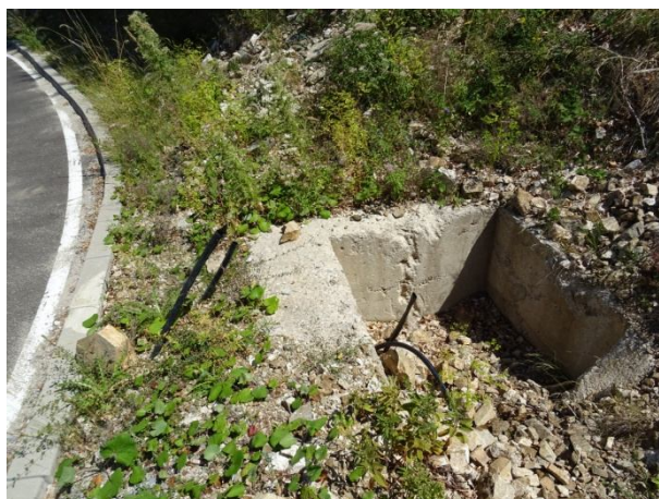
Вток на водостока при десния борд
