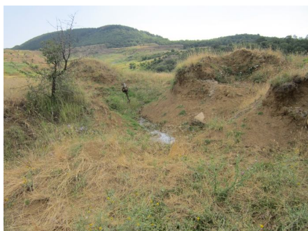
Теч от кран на водопровод /юли, 2017 г./
