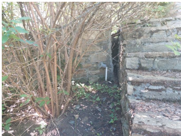
Деформирани стълбища и подпорни стени към югозападната сграда в УПИ I-571
