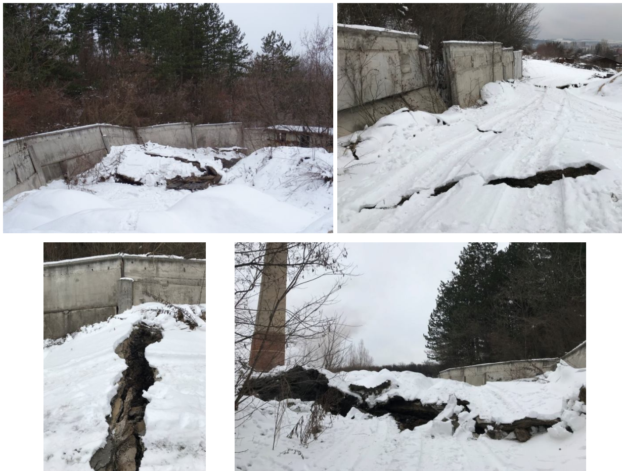
Разрушена бетонова оградна стена и свлачищни деформации
