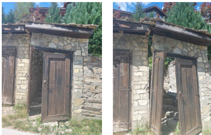
Силно деформирани входни врати към УПИ I-571 откъм югоизток
