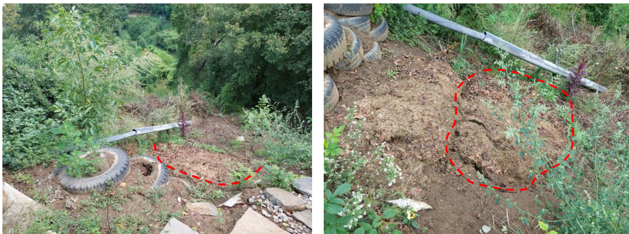
Локално повърхностно свличане под санитарния възел
