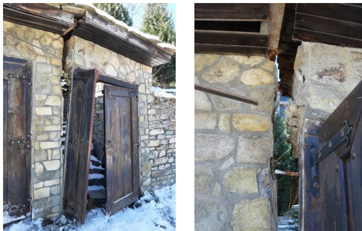
Деформация на входни врати /2021 г./
