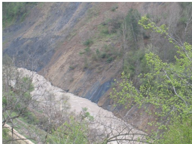
Засилена странична ерозия
