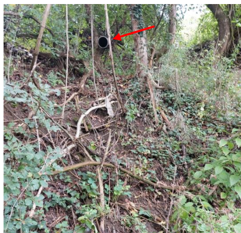
Отток на PVC тръбата от санитарния възел
