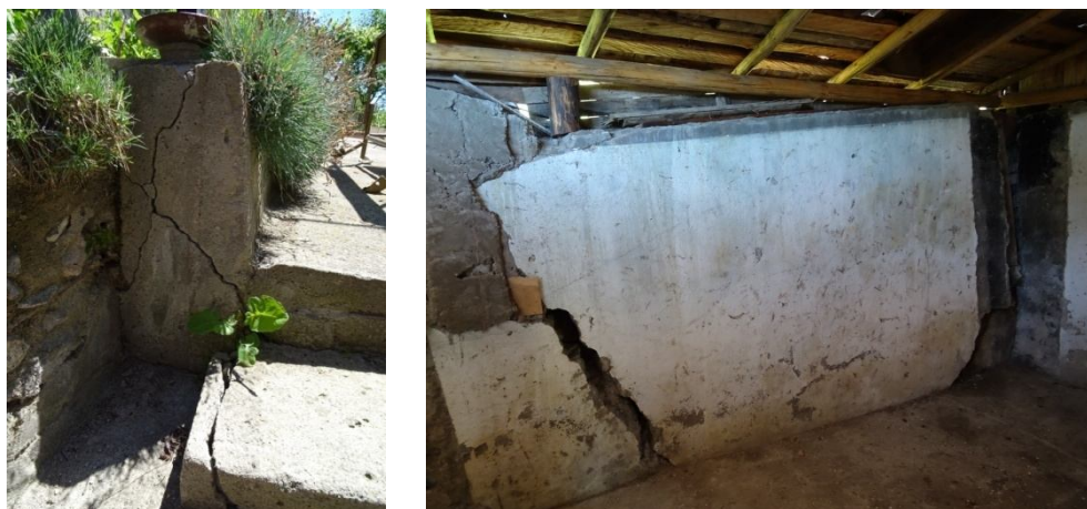
Състояние на регистрираните през 2015 г. деформации
