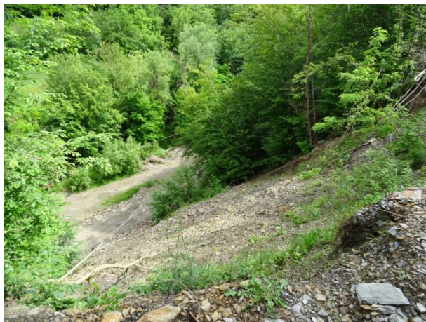
Свлачищен участък на път SFO 3611 при km 4 +150
