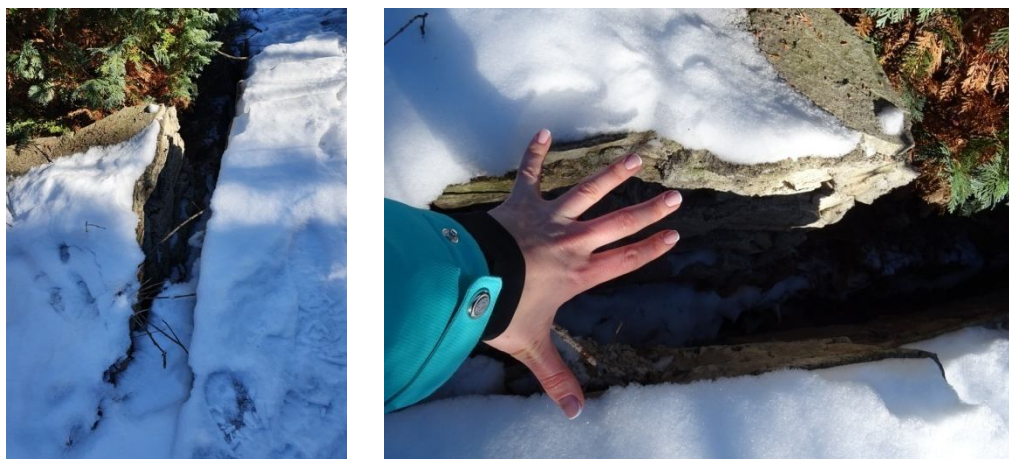
Отворена пукнатина на срязване в УПИ I-571, 2021 г.
