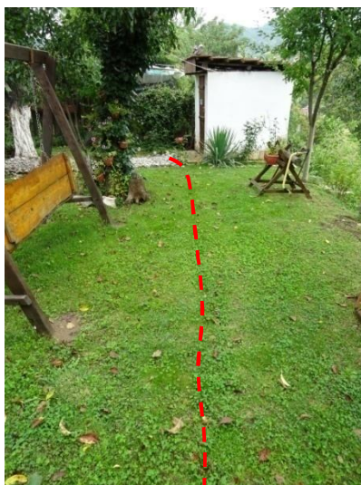
Деформация на срязване в УПИ III-230
