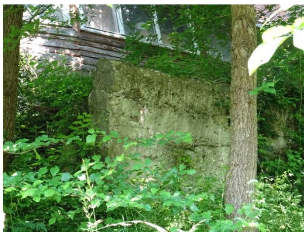
Неефективна стара подпорна стена
