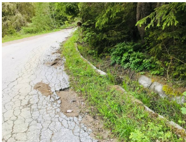
Отводнителна канавка преди свлачищния участък
