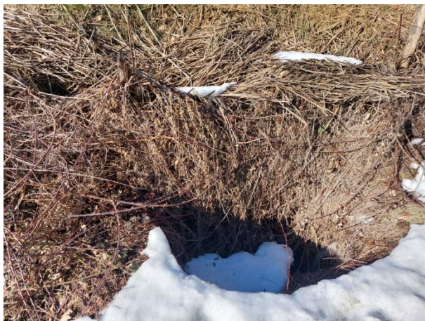
Запушен тръбен водосток
